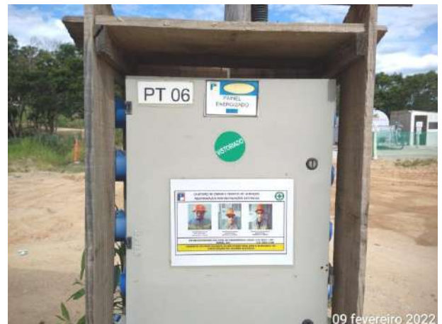
Foto 174 – Painel elétrico inspecionado, pátio da oficina mecânica. (Data:09/02/2022)
