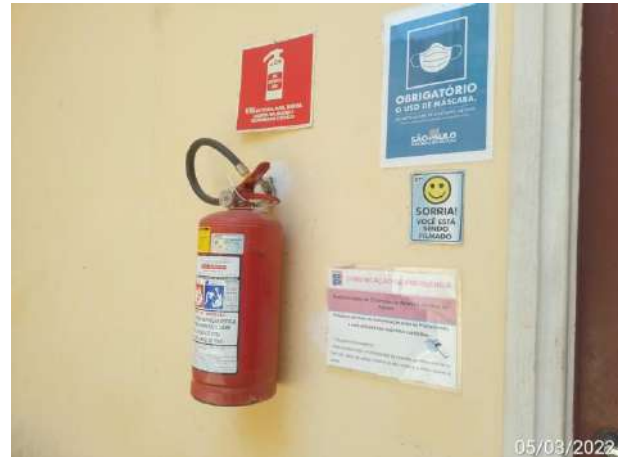
Foto 178 – Extintor com inspeção realizada no mês. (Data:05/03/2022)
