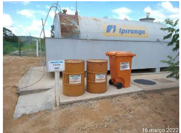
Foto 93 – Kit de emergência ambiental no posto de abastecimento. (Data:16/03/2022)
