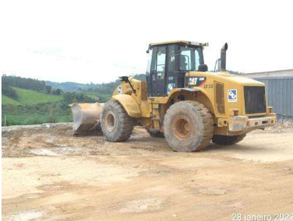
Foto 349 – Limpeza da área para lavagem de calha de betoneira – canteiro industrial. (Data:28/01/2022)
