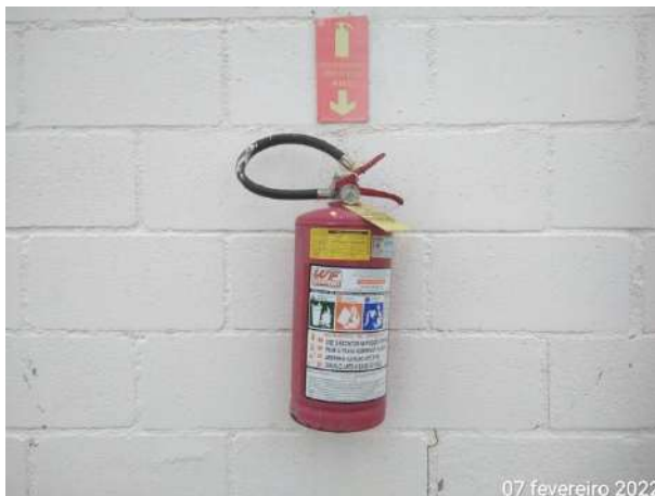
Foto 173 – Extintor com inspeção realizada no mês. (Data:07/02/2022)
