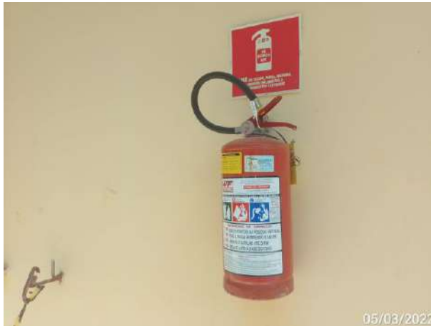
Foto 177 – Extintor com inspeção realizada no mês. (Data:05/03/2022)
