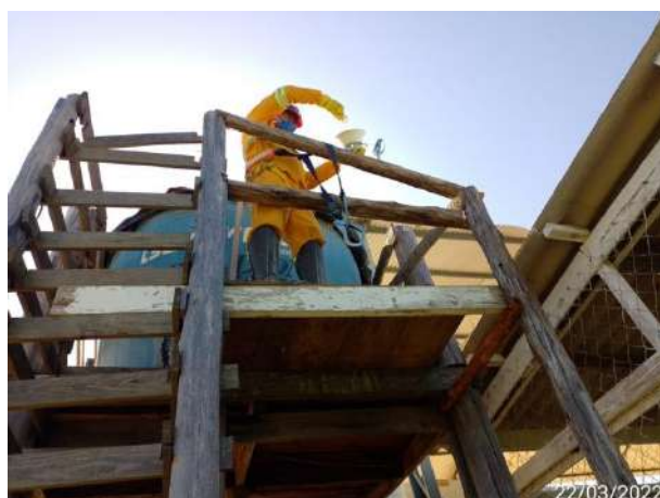
Foto 156 – Adequação de dosagem de cloro na caixa de água da oficina mecânica. (Data:22/03/2022)
