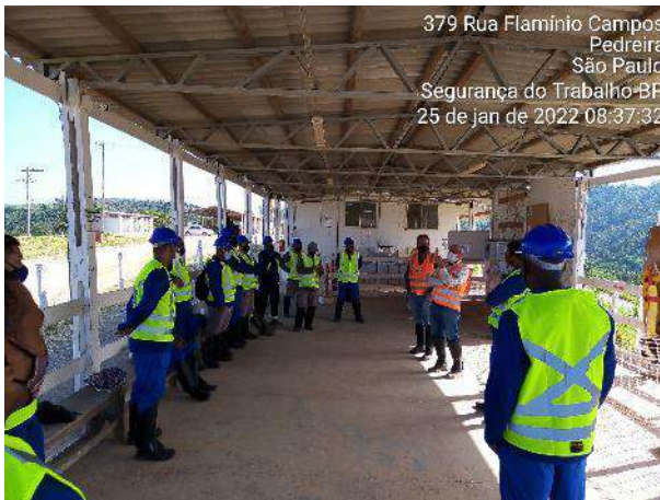
Foto 224 – Divulgação de APR. (Data:25/01/2022) Extintor com inspeção realizada no mês.
