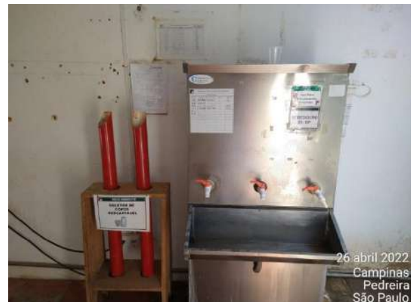
Foto 160 – Bebedouro do canteiro administrativo. (Data:26/04/2022)
