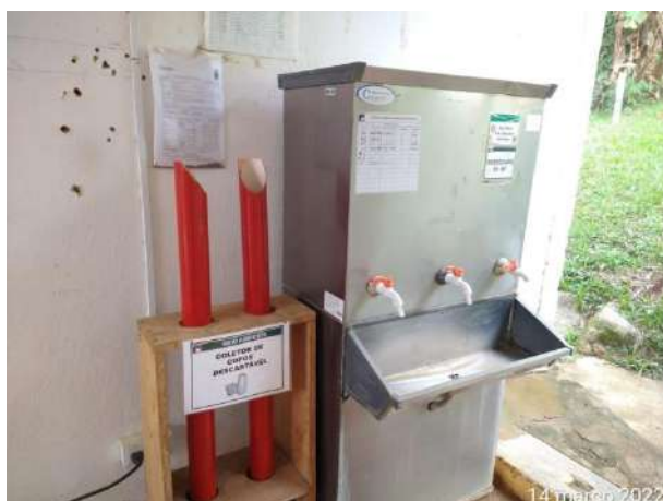
Foto 155 – Bebedouro do canteiro administrativo. (Data:14/03/2022)
