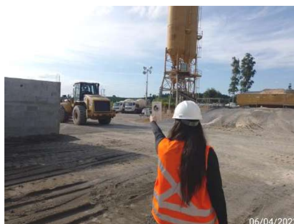
Foto 416 – Medição de fumaça preta em pá carregadeira. (Data:06/04/2022)
