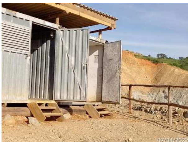
Foto 167 – Reutilização de madeira para fazer degraus de acesso aos containers na frente de serviço. (Data:07/04/2022)
