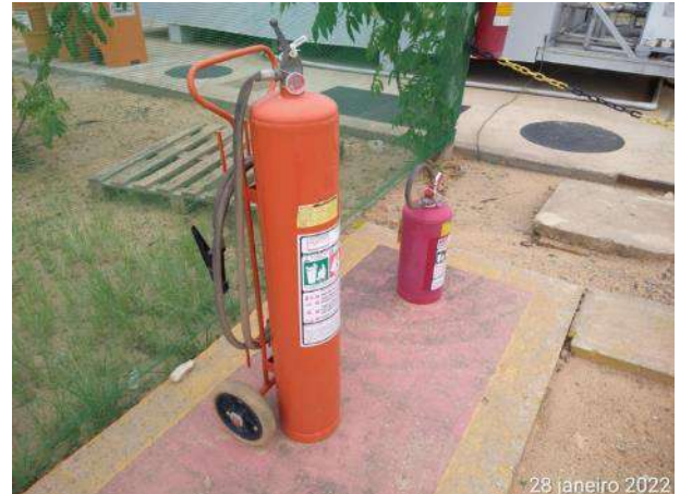
Foto 172 – Extintor com inspeção realizada no mês. (Data:28/01/2022)
