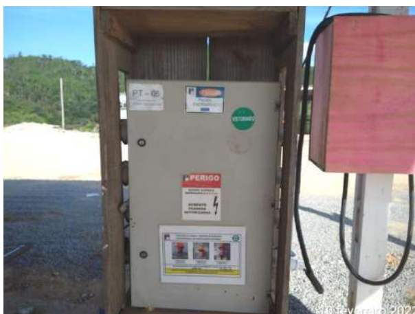
Foto 175 – Painel elétrico inspecionado, carpintaria. (Data:10/02/2022)
