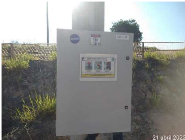
Foto 183 – Painel elétrico inspecionado na frente de serviço. (Data:21/04/2022)
