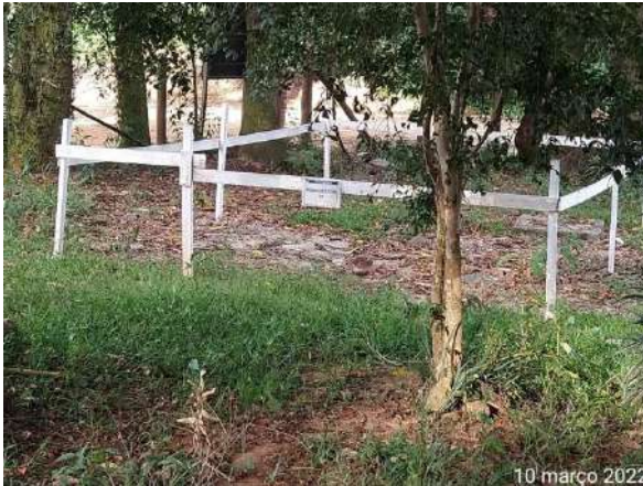
Foto 382 – Biodigestor 01 no canteiro administrativo. (Data:10/03/2022)
