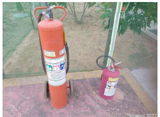
Foto 182 – Extintor com inspeção realizada no mês. (Data:12/04/2022)
