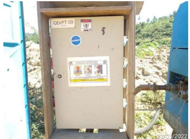
Foto 180 – Painel elétrico inspecionado na frente de serviço. (Data:22/03/2022)
