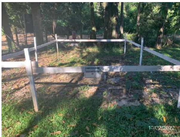
Foto 380 – Biodigestor 01 no canteiro administrativo. (Data:10/02/2022)
