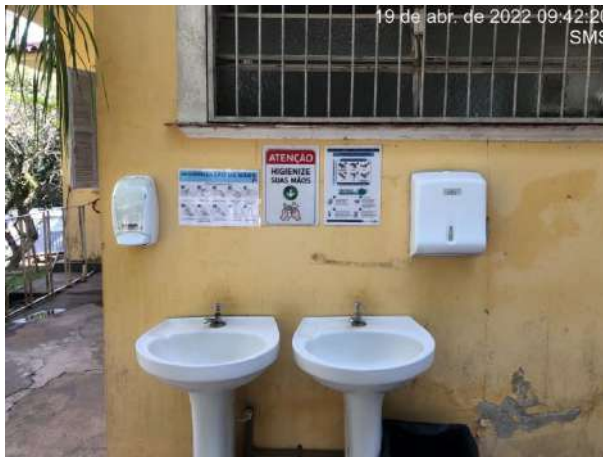
Foto 209 – Pias para higienização das mãos no canteiro administrativo. (Data:19/04/2022).
