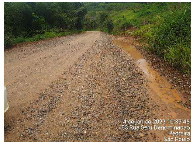
Foto 320 – Inspeção no direcionamento de água próximo ao bota fora IIIA da margem direita, dia de chuva. (Data: 04/01/2022)
