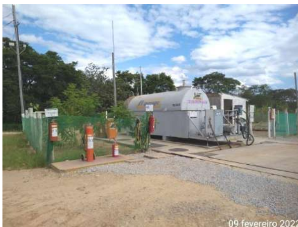
Foto 69 – Ponto de abastecimento. (Data:09/02/2022)
