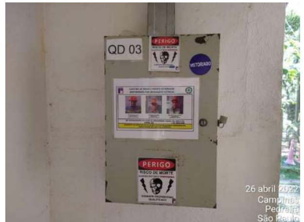
Foto 184 – Painel elétrico inspecionado na frente de serviço. (Data:26/04/2022)
