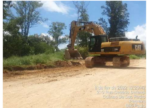
Foto 303 – Leira para direcionamento de água no acesso ao canteiro industrial. (Data:08/02/2022)
