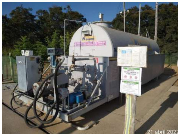
Foto 79 - Ponto de abastecimento. (Data:21/04/2022)
