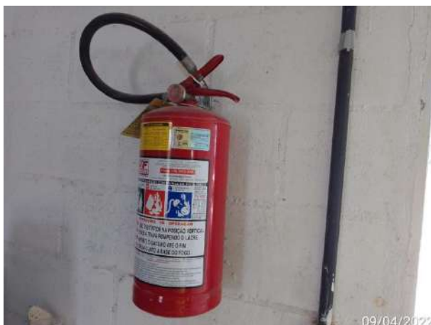
Foto 181 – Extintor com inspeção realizada no mês. (Data:09/04/2022)
