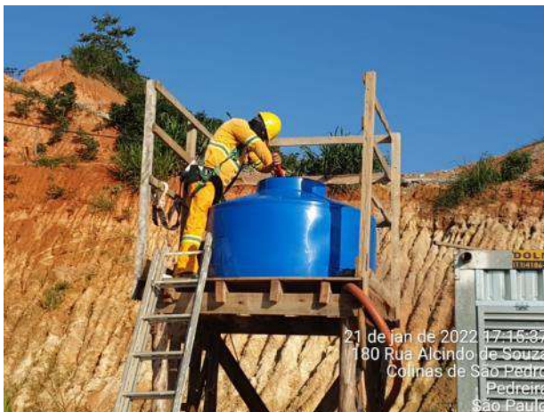
Foto 147 – Abastecimento da caixa de água do canteiro industrial. (Data:21/01/2022)
