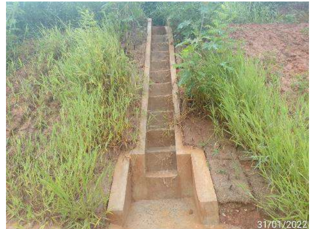
Foto 328 – Monitoramento de escada hidráulica no acesso da MD03, em dia de chuva. (Data:31/01/2022)
