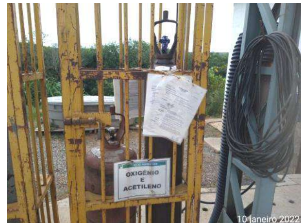
Foto 62 – Produtos químicos devidamente identificados na oficina mecânica (Data:10/01/2022)
